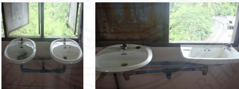
อ่างล้างอุปกรณ์แบบอ่างล้างหน้าไม่ได้มาตรฐาน
